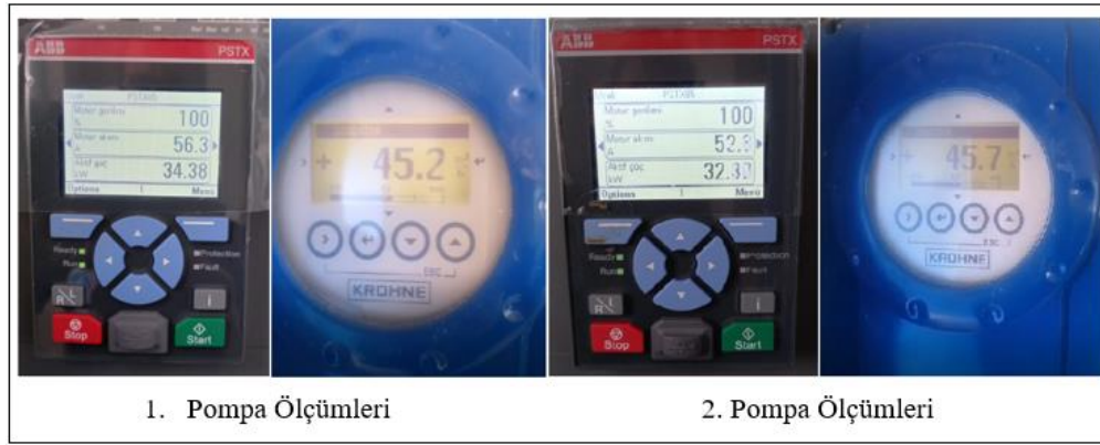
Şekil 10. Yeni pompa grubuna ait enerji tüketim ve debi ölçümleri.
