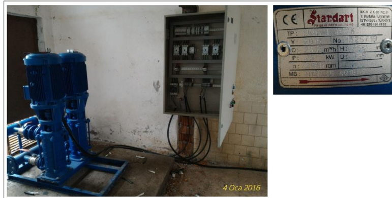
Şekil 2. Mevcut pompa grubuna ait görseller
